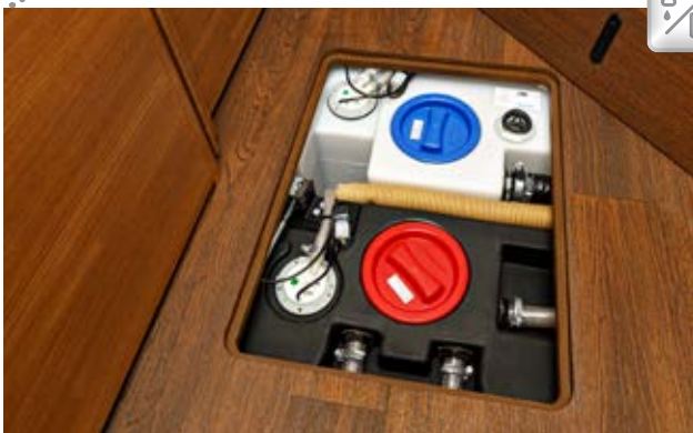
Vattentankar frostsäkra i det uppvärmda dubbelgolvet
