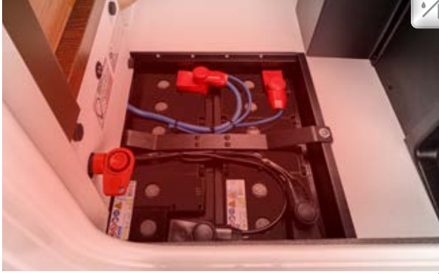
Uppvärmad battericentral med huvudbrytare. Standard: Gelbatterier 2 x 80 Ah, lättåtkomligt placerade i utvändigt förvaring på passagerarsidan, tillval litiumjonbatteri, 90 Ah inklusive batteridator och separat pekdisplay
